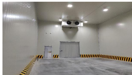
-25°Cの冷凍倉庫
